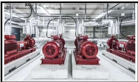
Pompes à chaleur
